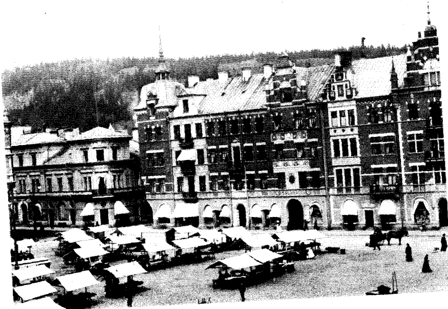
Vintern 1895 påbörjade Alfred Larsson Blomberg schaktningsarbetena för handlaren Otto Holmströms hus med saluhall vid Stora torget. På våren lades grunden.
